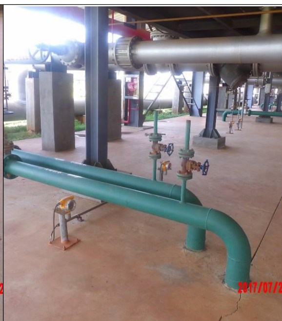
照片 4 泄漏检测系统布点
