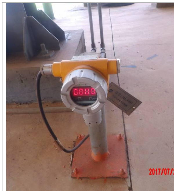
照片 3 可燃气体泄漏检测仪
